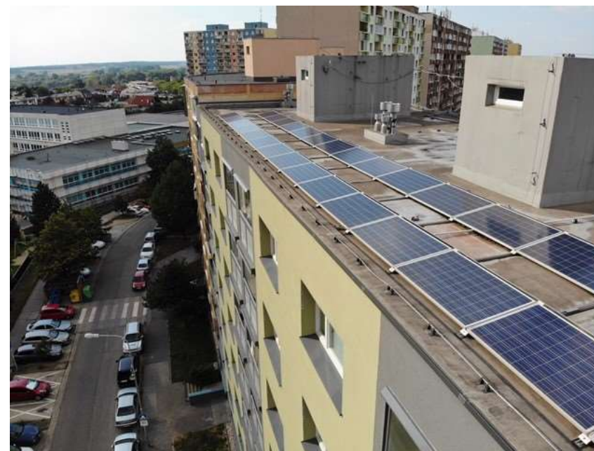
Na streche bytového domu inštalovaný fotovoltický zdroj s výkonom 10KWp, zdroj : Arthur Lankester
